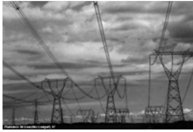
Figura 6. Líneas de Transmisión de 765 kV, salida de la Subestación Guri, propiedad de EDELCA, Guri, Edo Bolívar, Venezuela.
